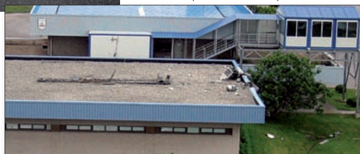
Resztki klimatyzatora na dachu budynku
